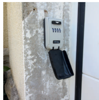
Accès boîte à clé située sur la partie gauche de la porte de garage Code : transmis le jour de votre arrivée
